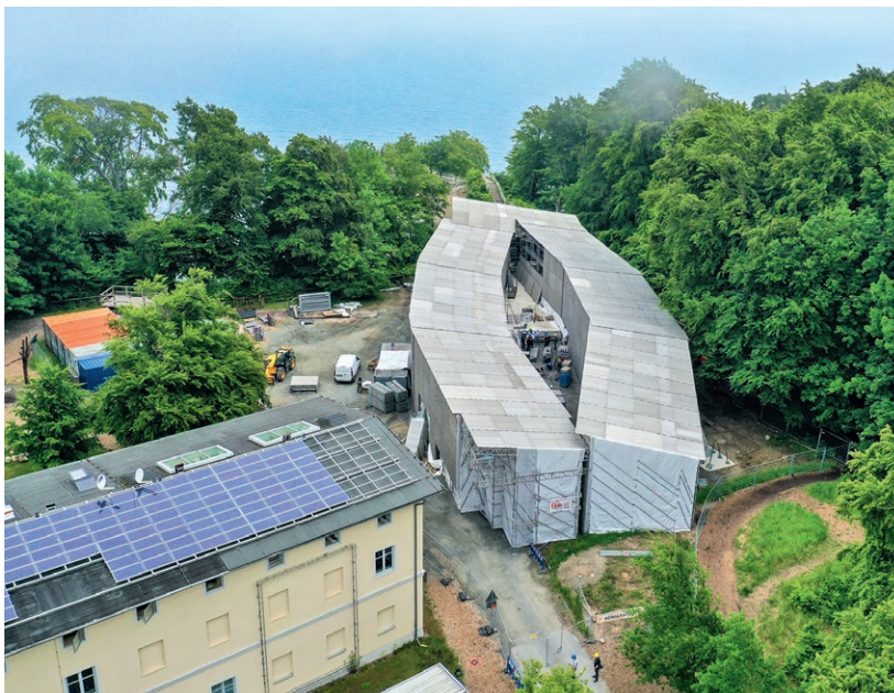
Noch ist der Königsweg eingehaust. Besonders interessant wird der Vorschub der Brückenkonstruktion.
